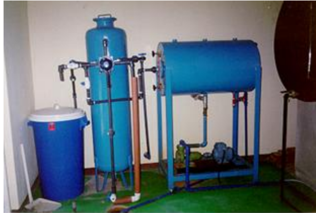
Ilustración No.3 Tanque regenerador, suavizador y de alimentación
