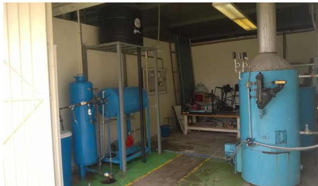
Ilustración No. 1 Sistemas que integran la Caldera San Francisco
