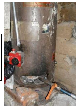
Figura 3. Calentador de Agua con quemador de biogás.
