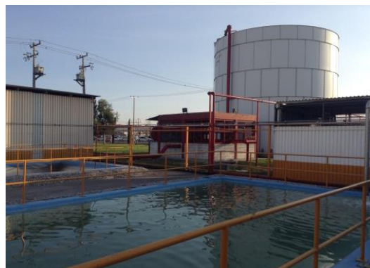
Figura 1. Planta tratadora de agua Continental Tyre
