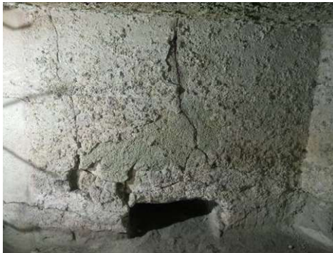
Figura 1. Grietas en paredes de refractario
