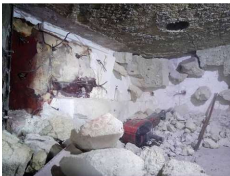
Figura 3. Anclas metálicas dañadas
