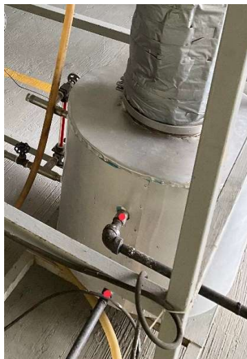
Figura 5. Hervidor de una columna de destilación de la Planta Piloto.
